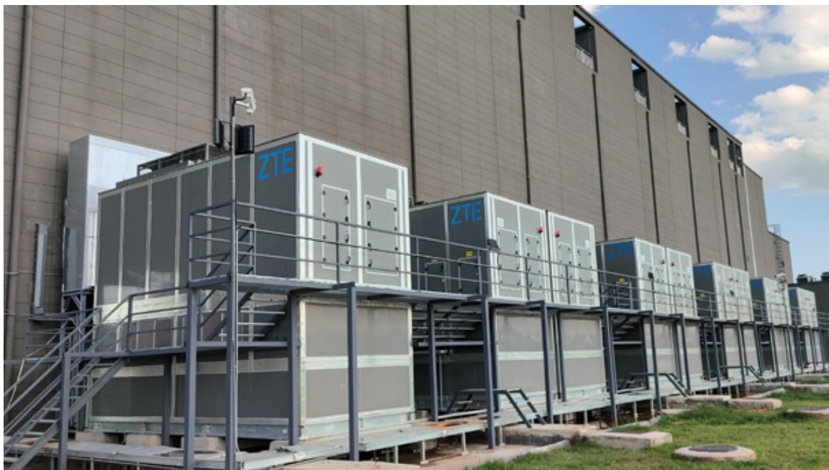
中兴通讯IEC空调现场实景图
